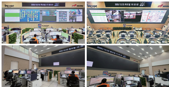
대구광역시 소방본부 119종합상황실 내 119긴급구조시스템을 포함한 전 시스템 이전 및 상황실 구축
