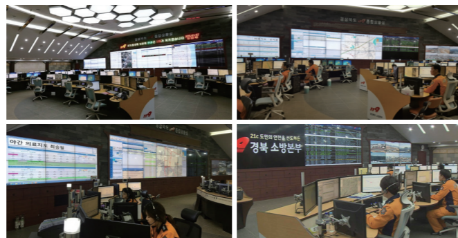
경상북도 소방본부 119종합상황실 내 119긴급구조시스템을 포함한 전 시스템 이전 및 상황실 구축
